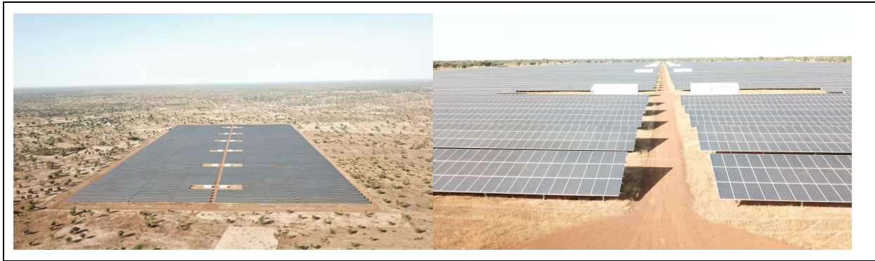
Photo 1 : Visite centrale solaire Ten Merina
