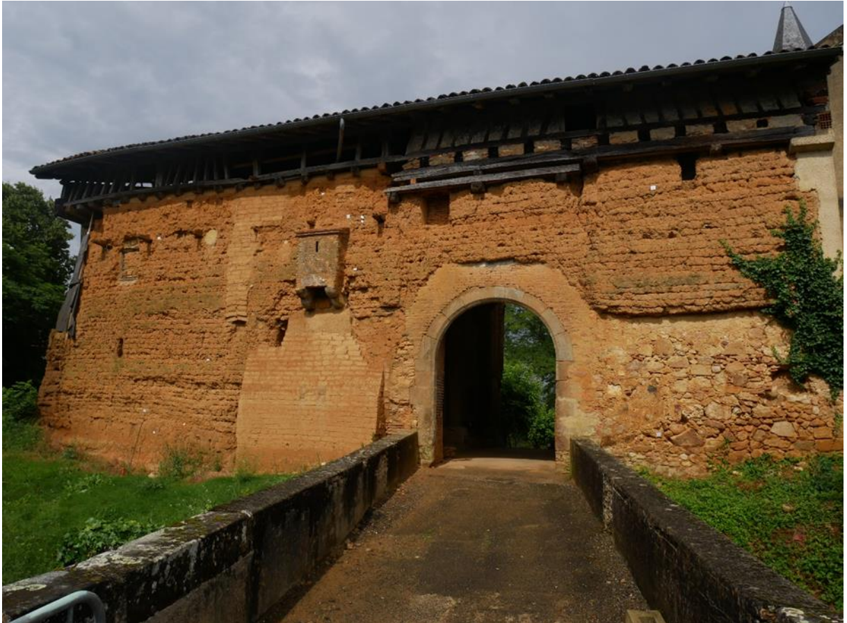
Fig. 18 - Photographie du rempart en terre massive en 2022 après restauration prise depuis l'ouest (L. Soulard)
