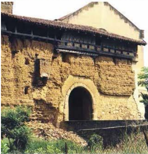
Façade ouest du monument en terre crue, avant sa restauration : une succession de couches de terre crue filantes.
