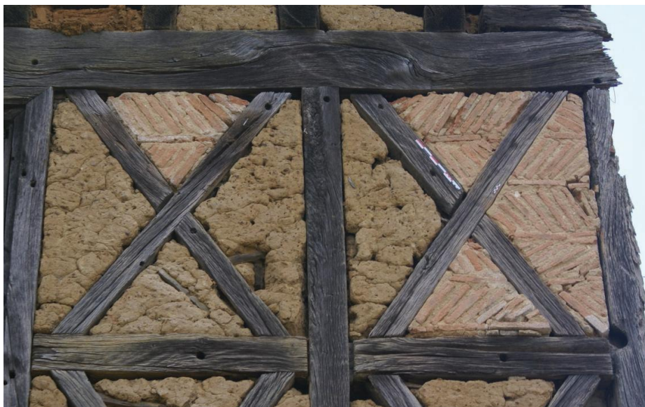
Fig. 25 - Panneaux hourdis en briques cuites de la façade orientale, 1er étage (A. Klein)
